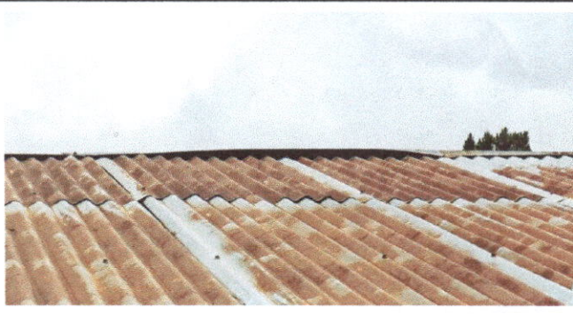
Foto 4: Lámina en mal estado, del módulo 1 de aulas. Con 381 M2.
