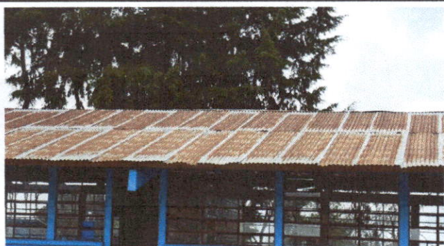
Foto 3: Lámina en mal estado, del módulo 1 de aulas. Con 381 M2.
