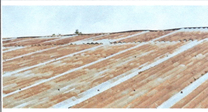
Foto 2: Lámina en mal estado, del módulo 1 de aulas. Con 381 M2.
